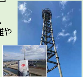
携帯電話基地局の中に設置した無線基地局（LPWA）
