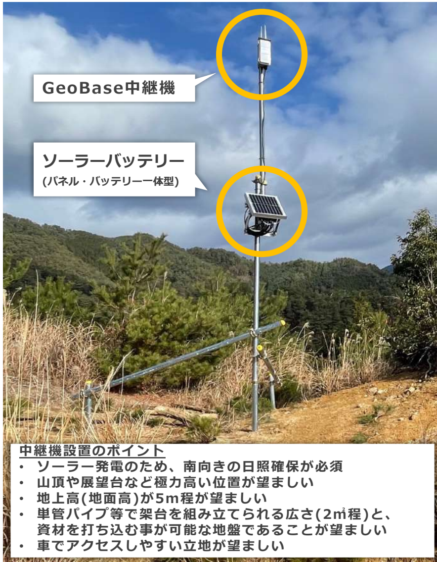
GeoBase Dual Repeater (2ポートタイプ中継機) 設置事例
