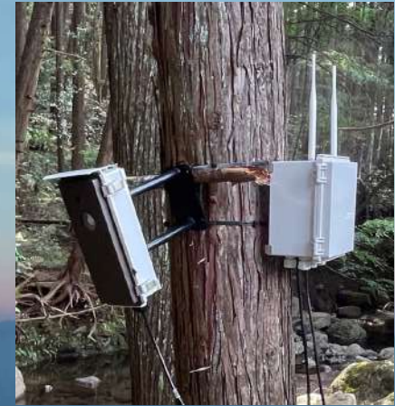
GeoCam (カメラ映像監視)
