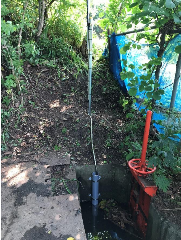
用水路への水位センサーの設置時の全景図
