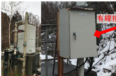
温泉ポンプ ポンプ制御盤
