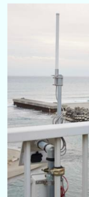
静止画カメラ (河口閉塞監視)
