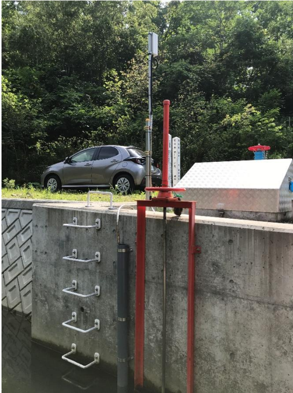
ファームポンドに隣接した 河川の水位監視用センサー
