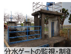
分水ゲートの監視・制御
