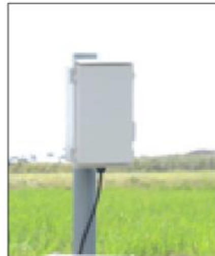
自動給水弁 通信ボックス
