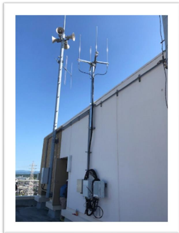
袋井市役所屋上に整備した基地局
