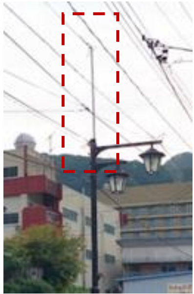
電灯に共架に線路 (会津若松市 芦ノ牧)
