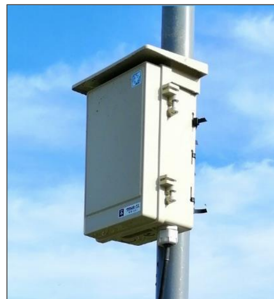
自動給水弁 通信ボックス
