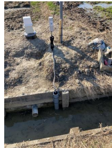
田んぼダム用自動落水升/ 用水路水位センサ
