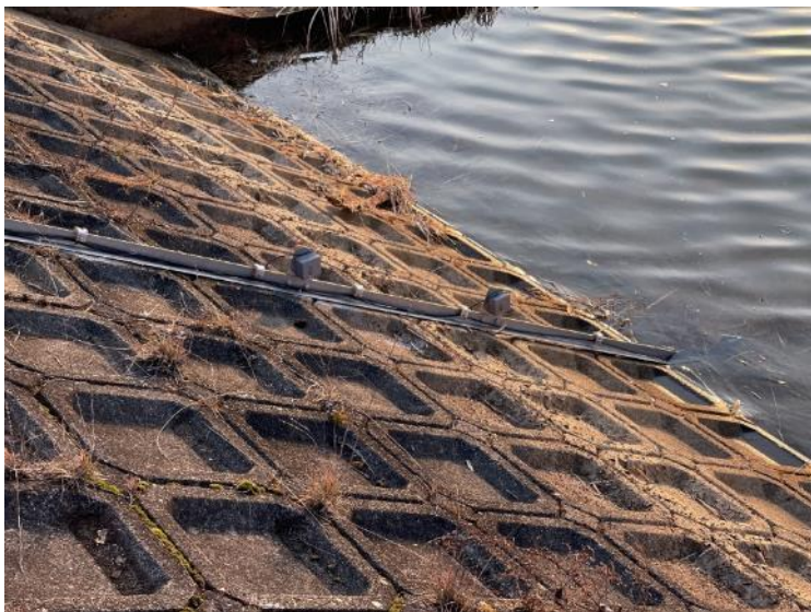
ため池用水位センサー
