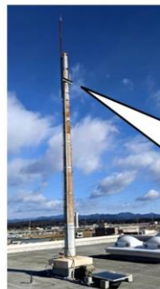
LPWA 基地局 (袋井市役所屋上)
