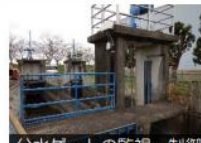
分水ゲートの監視・制御
