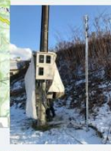
温泉汲み上げポンプ流量稼働状況監視センサー
