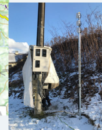
温泉汲み上げポンプ流量 稼働状況監視センサー
