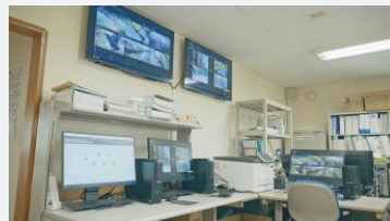
中央制御監視システム
