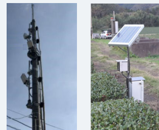
無線機 LPWA基地局
