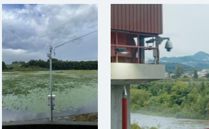
遠隔監視システム
