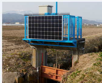
リモート排水ゲート
