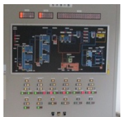
拠点A 監視盤
