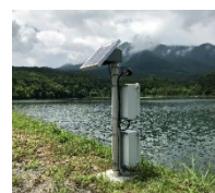
ため池監視装置
